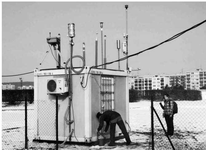
Hlavní stanice - kontejner
