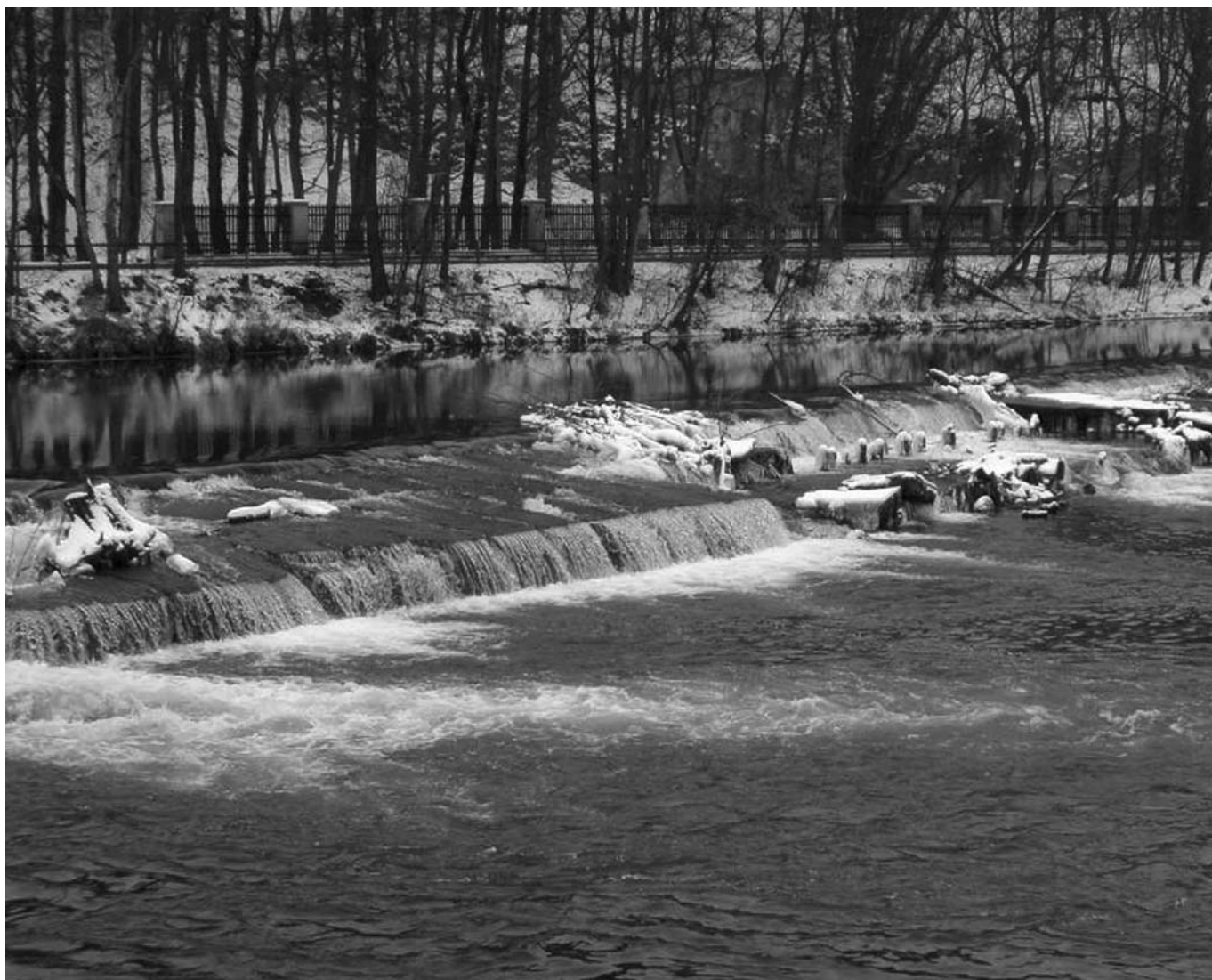
Pevná část jezu v havarijním stavu
